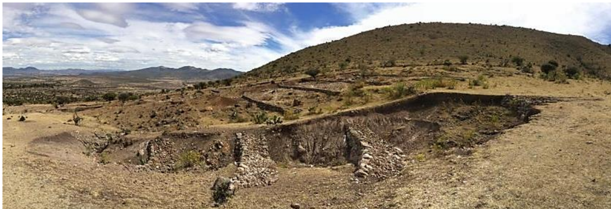
Fotografía 2. Presas filtrantes en primer plano y al fondo terrazas a curva de nivel, ambas construidas con piedra acomodada del lugar.
